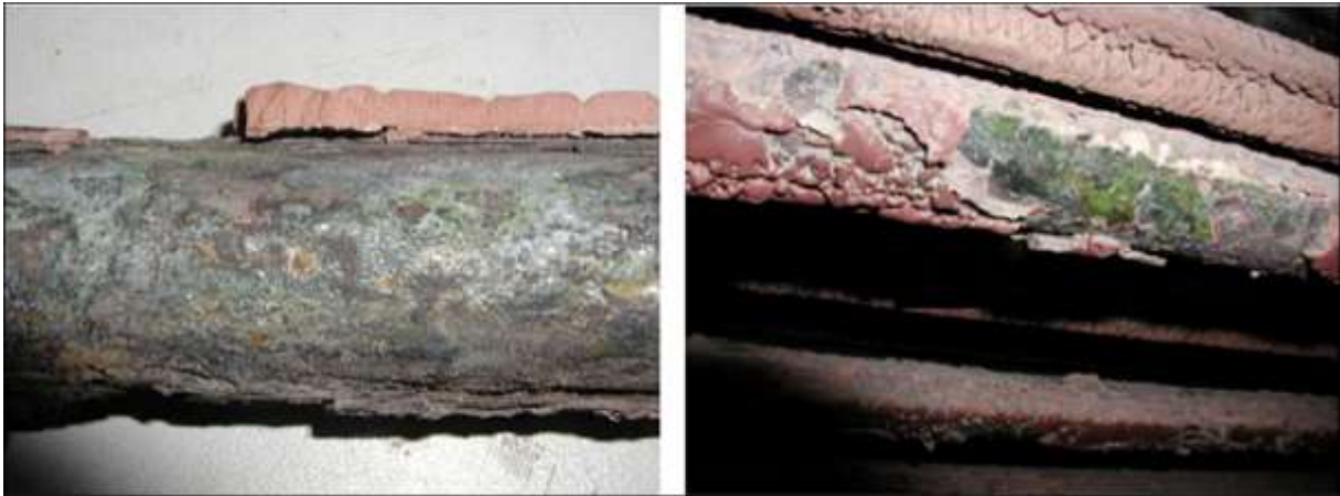
Figure 3-3. Corrosion dans la chaudière lors de la combustion de la biomasse.
