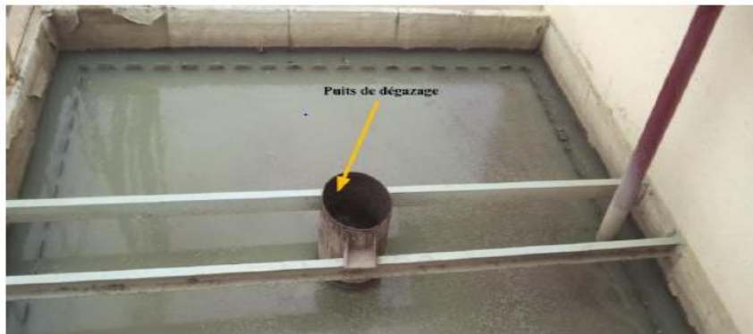
Figure 15 : Zone de clarification et de dégazage
