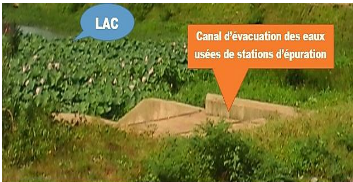
Figure 5 : Canal d'évacuation d'eaux usées d'une station d'épuration non fonctionnelle, située au quartier Riviera près du lac 5 (CHR) (Anoman et al. , 2019)
